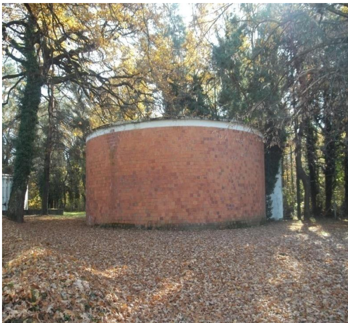
Slika 4. Zidani rezervoar za vatrogasnu vodu (snimila Mirna Karzen, 2015.)
